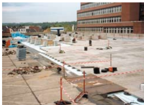
Altes schadhafte Parkdach (links) neben dem neuen Pardak®-Belag (rechts), der sofort befahren werden kann
