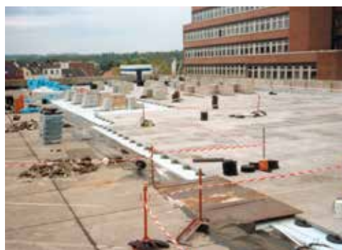
Altes schadhafte Parkdach (links) neben dem neuen Pardak®-Belag (rechts), der sofort befahren werden kann
